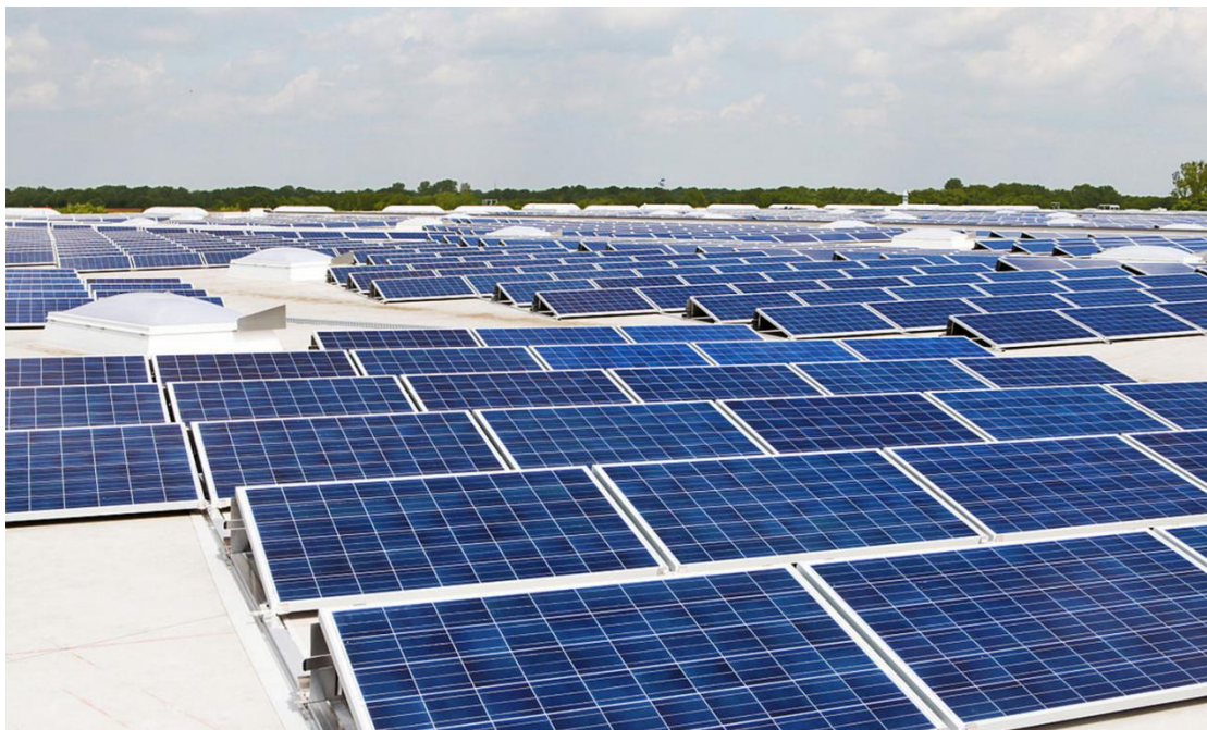
Placas fotovoltaicas utilizadas para transformar energia solar em elétrica. Fonte: LadeSol
