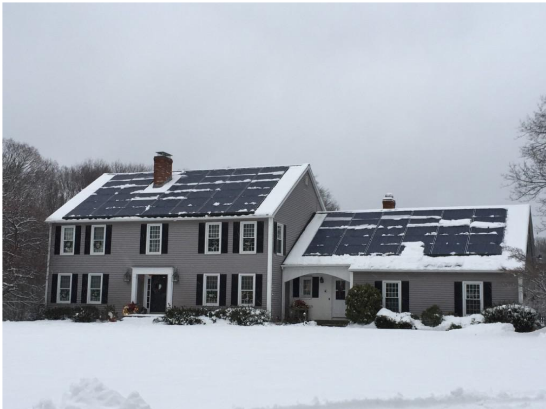
O sistema fotovoltaico funciona até mesmo em países com inverno rigoroso. Fonte: Solar Power Utah
