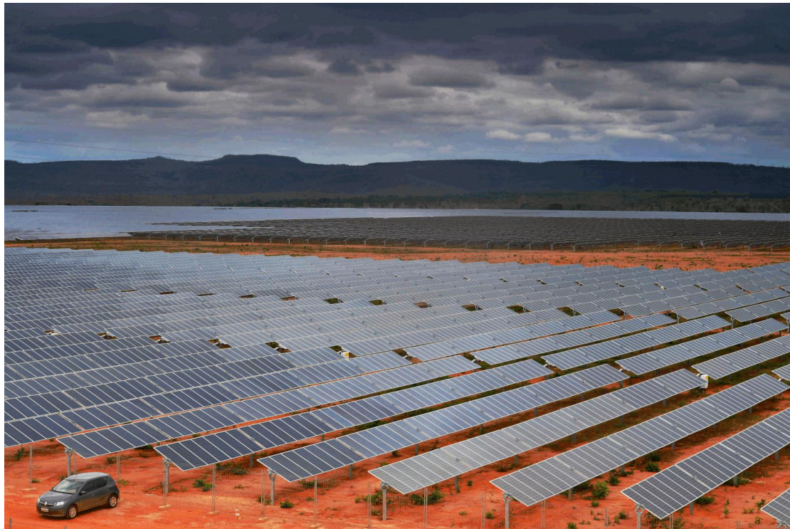
Usina Solar Pirapora, responsável por gerar mais de 300 Megawatts de energia elétrica. Fonte: Solenerg
