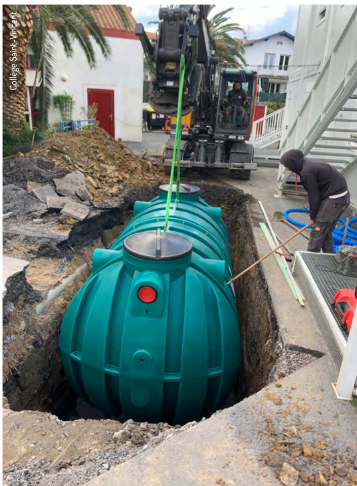
Une cuve a été installée pour récupérer les urines.
