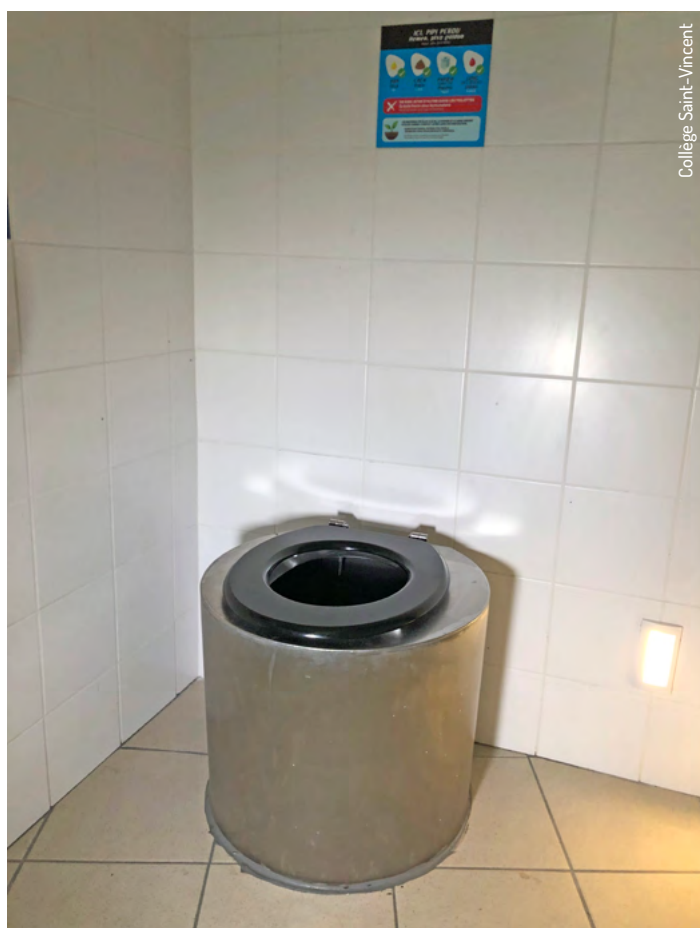
Le collège a aussi installé des toilettes sèches gravitaires. Les matières fécales et les urines sont réunis dans une cuve de compost.
