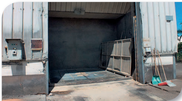
Chaque matière première passe en fosse de déchargement et arrive dans l'une des 12 cellules de stockage.
