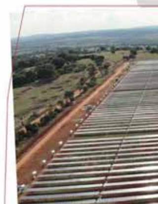
USINA DE ENERGIA SOLAR DA VIVO NO DISTRITO FEDERAL
