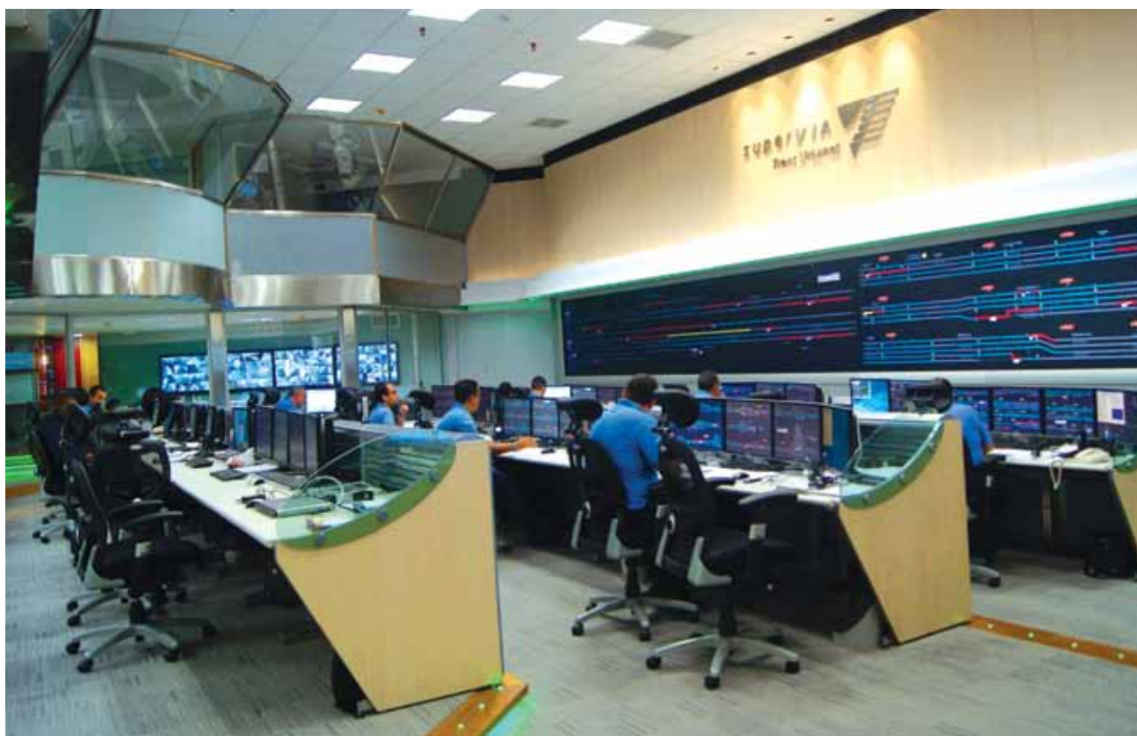
Montado inteiramente com tecnologia nacional, o moderno Centro de Controle Operacional da SuperVia está aperfeiçoando a segurança do sistema
