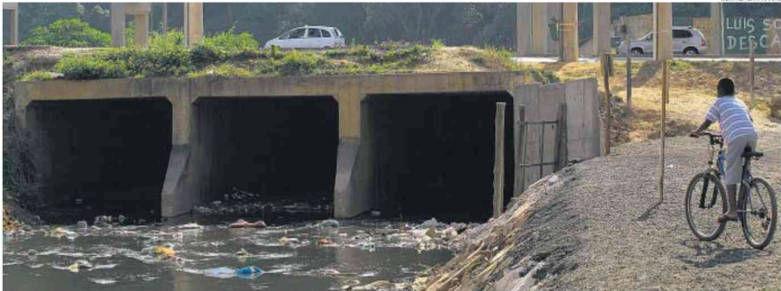
Sujeira à vista no Guichi Suigueta. Além do descarte irregular de resíduos, os canos de ligação de esgoto improvisados dificultam a limpeza dos riberões
